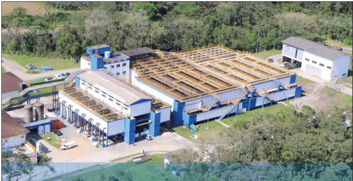
Figuras 12, 13 e 14: Obra de ampliação da ETA Cubatão (12/2020) Fonte: CAJ.DITEC.GEX / Crédito imagem aérea: Bruno Gentil
