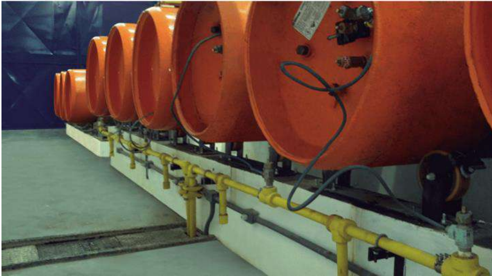
Foto 5 – Sistema de armazenamento de gás cloro da CAJ
