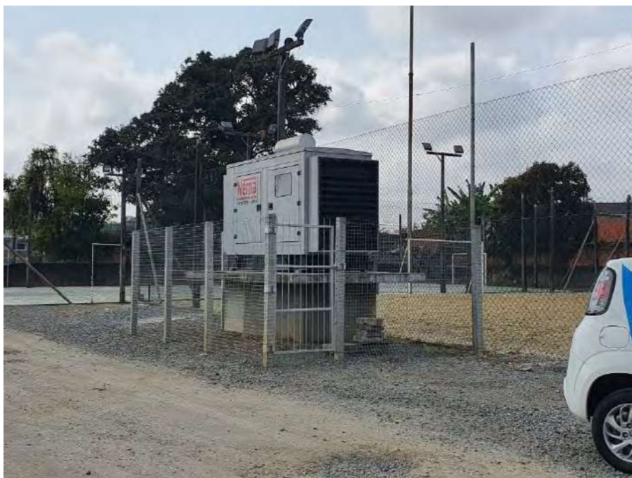
Foto 2 – Gerador da EEE de Grande Porte da Bacia 7
