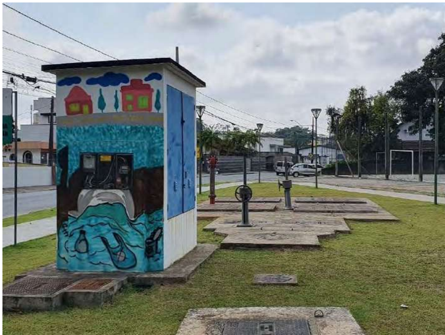
Foto 1 – Estação Elevatória de Grande Porte Existente na Bacia 7
