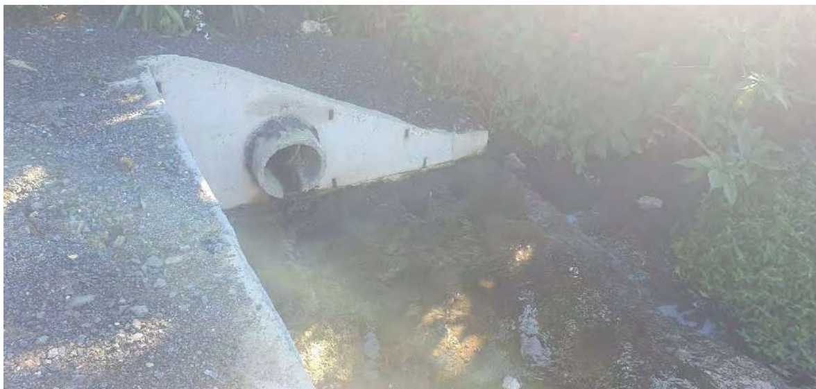
Foto 49 – Detalhe de drenagem pluvial subterrânea próxima ao local de implantação da EE19
