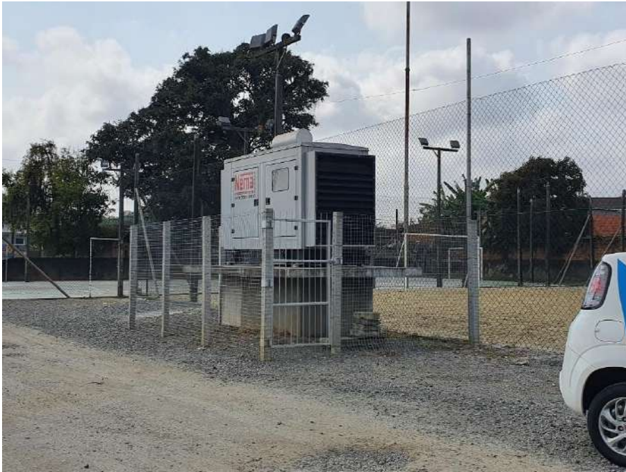
Foto 3 – Gerador da EEE de Grande Porte da Bacia 7
