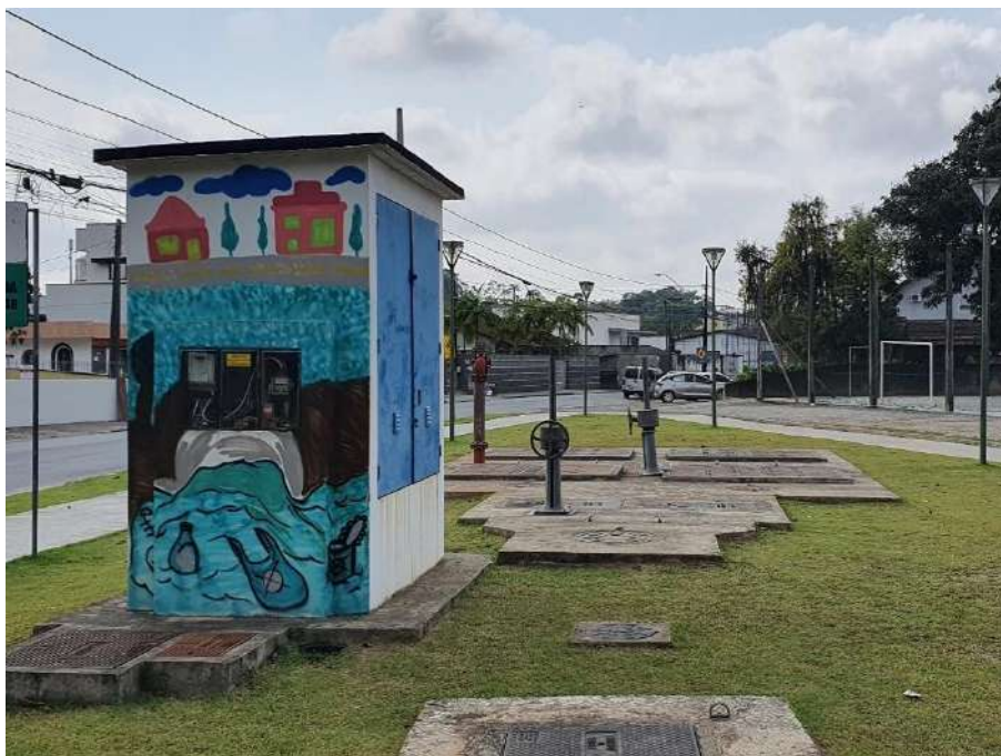
Foto 2 – Estação Elevatória de Grande Porte Existente na Bacia 7
