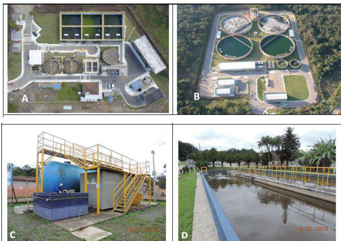
Figura 4. ETEs em operação em Joinville: A) ETE Espinheiros; B) ETE Jarivatuba; C) ETE Morro do Amaral; D) ETE Profipo.
