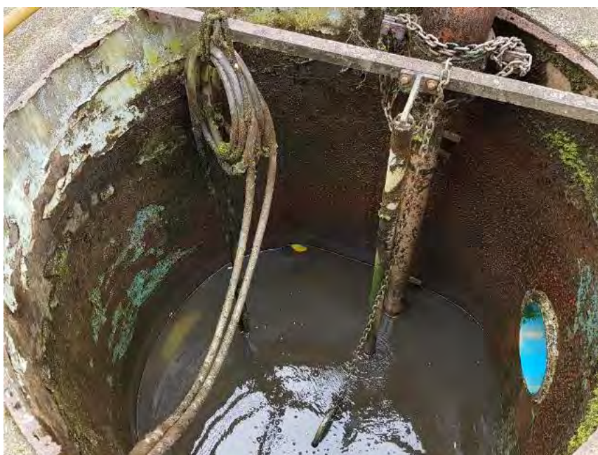
Foto 6 – Poço de recebimento e bombeamento da água de lavagem dos filtros
