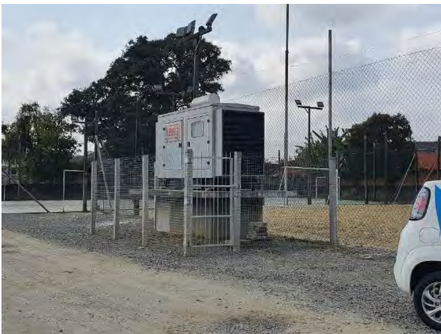
Foto 15 – Gerador da EEE de Grande Porte da Bacia 7
