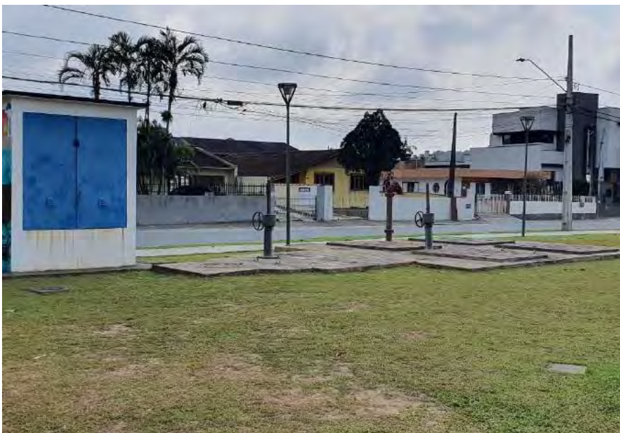
Foto 14 – Estação Elevatória de Grande Porte Existente na Bacia 7
