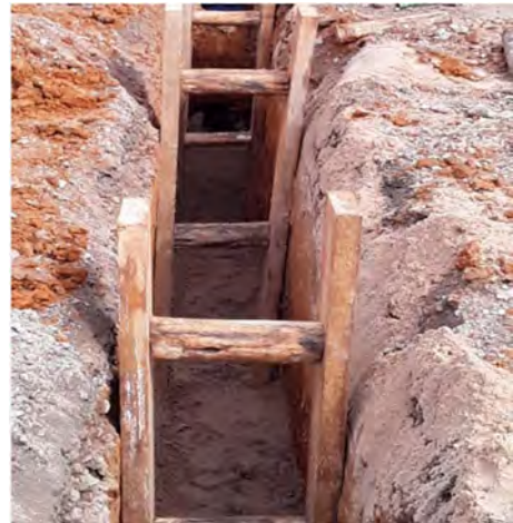
Figura 10 – Escoramento tipo Pontalete (Fonte: CAJ)
