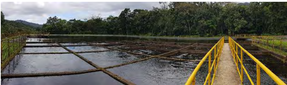
Foto 3 – Tratamento (floculação e decantação)
