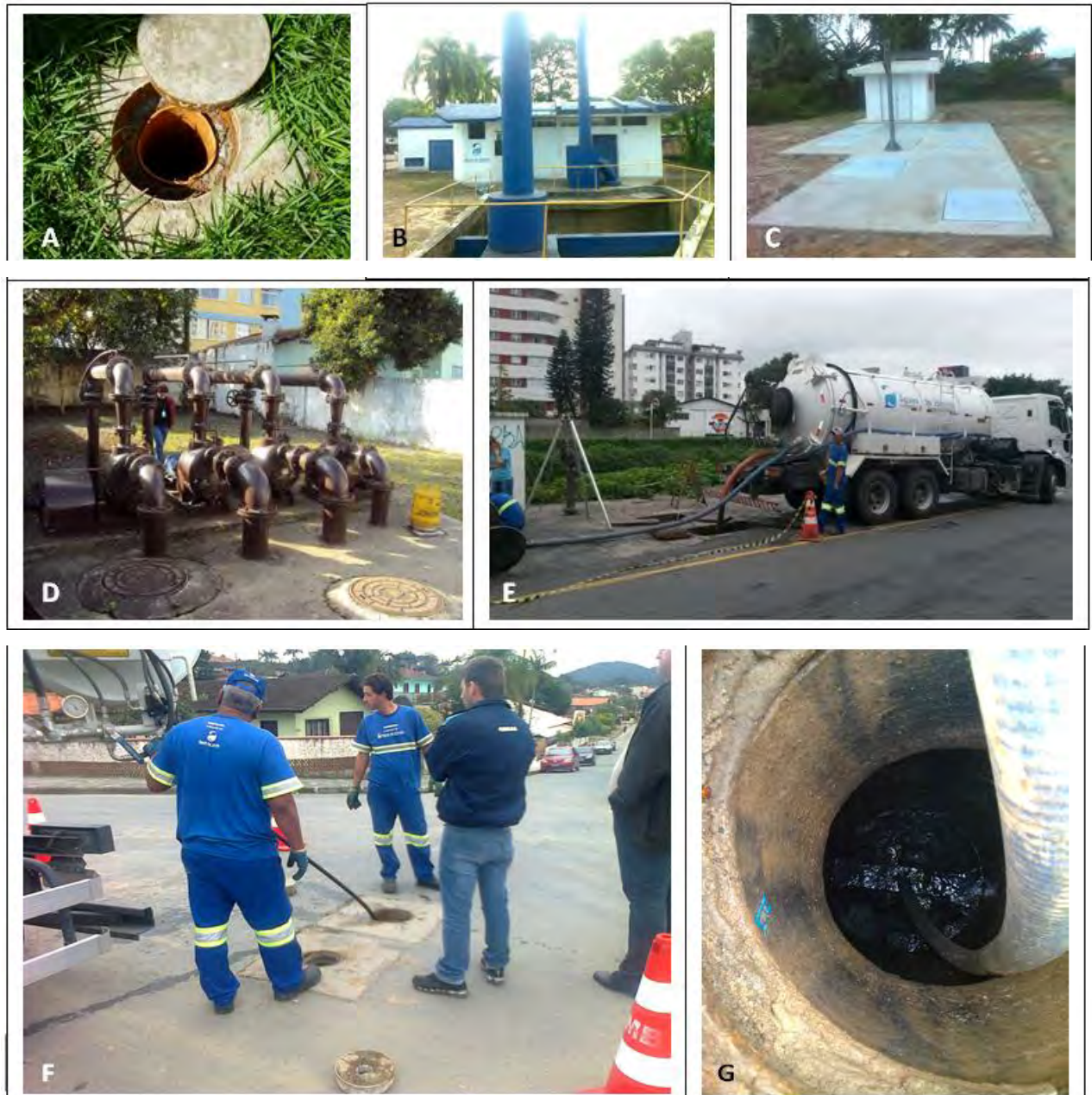
Figura 5. SES Joinville: A) Caixa de Inspeção da Ligação de Esgoto; B) ER-Centro; C) ER – D5 Nova Brasília; D) ER-Miguel Couto; E) Limpeza Gradeamento ER-Angeloni; F) Desobstrução de Rede – Nova Brasília; G) Poço de Visita.
