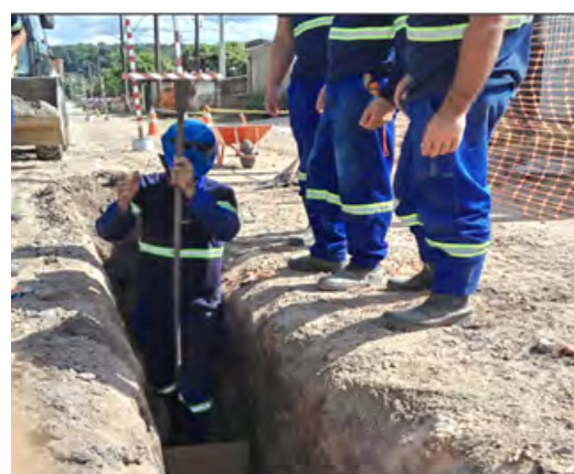
Execução do assentamento e posicionamento do tubo junto à bolsa com tábua de proteção e alavanca
