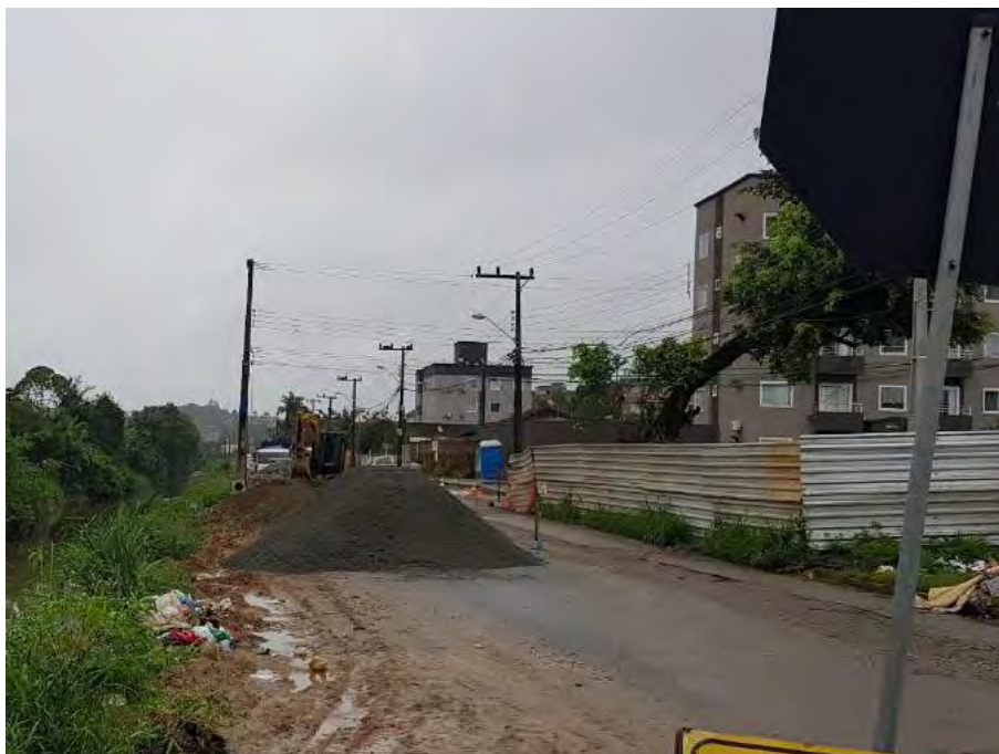
Foto 19 – Vista do terreno com tapumes onde está sendo instalada a EEE de Grande Porte da Bacia 8.1 Etapa 5
