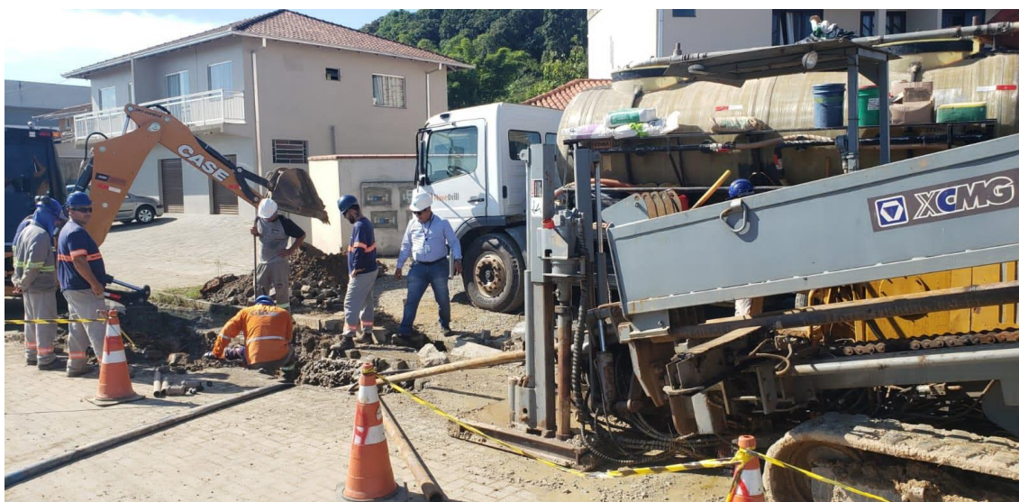
Foto 2 – Exemplo de Implantação de Rede de Esgotamento através de MND – Poço de Lançamento no Sistema Viário.
